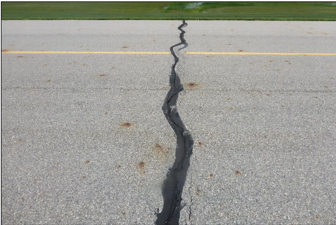
CKN PTA 002 (PCI = 89)
