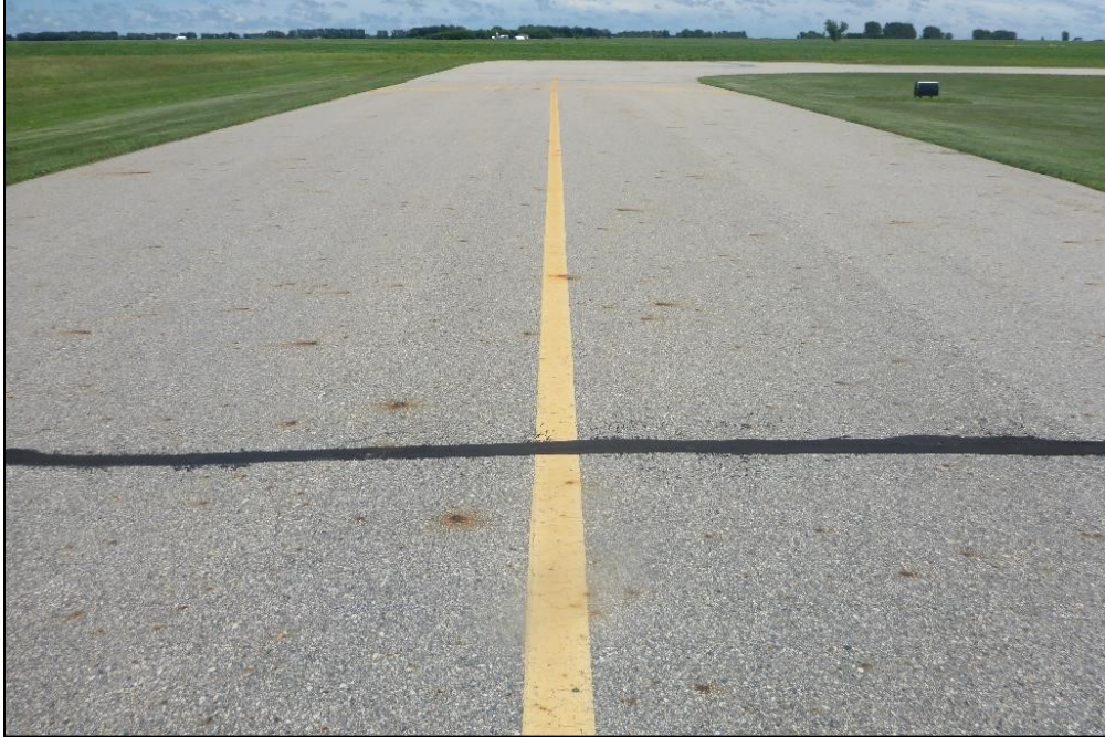
CKN PTA 002 (PCI = 89)
