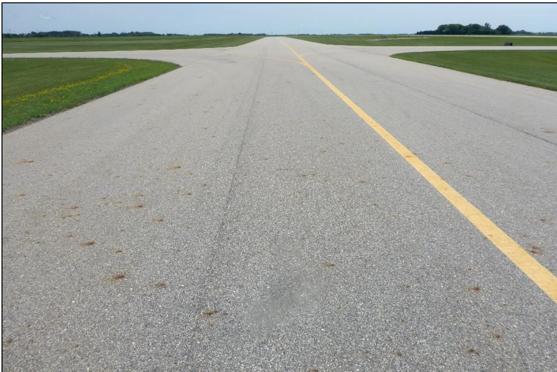
CKN PTA 001 (PCI = 85)
